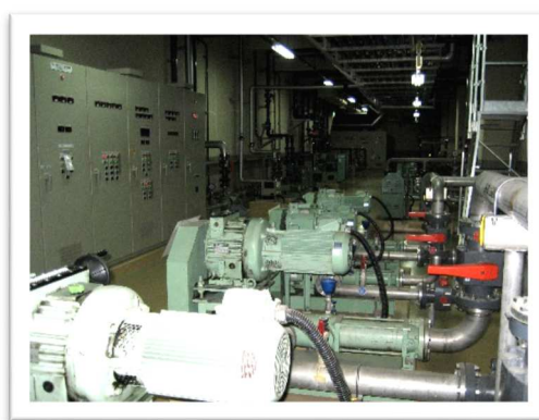
地下ポンプ室
