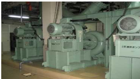
し尿処理施設の安定稼働 1億3,860万円
